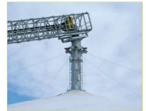
Dans le cas d'un chargement par tour, la mise en place de la bâche est automatisée.
