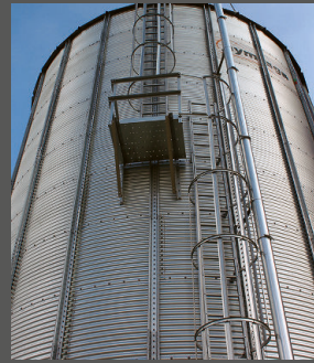
ECHELLES D'ACCÈS AU TOIT DEPUIS LE SOL
